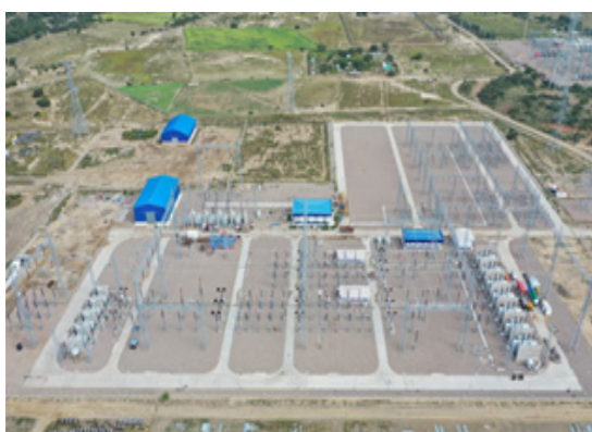
Subestación Santivañez 500 kV
